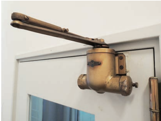
写真 32. キャットウォークへの扉に設置された壺形ドアクローザー
