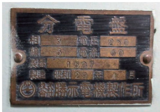
写真 40. 分電盤の銘板 うっすらと「昭和 29 年 4 月」と「株式会社勝亦電機製作所」が読み取れる。
