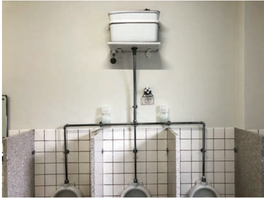
写真 35. 男子トイレ小便器の水洗設備
