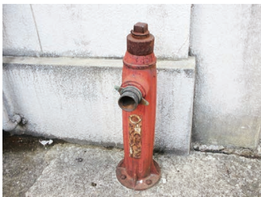
写真 12. 中庭に設置された専用消火栓
