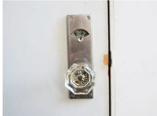
写真 37. トイレ個室のドアノブ 施錠により「使用中」「あき」の表示が変わる。
