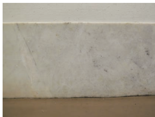
写真 31. VIP エリア廊下の幅木（吹抜側）
